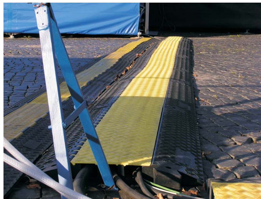
Bild 5: Zwei Kabelbrücken nebeneinander (ungünstig)
