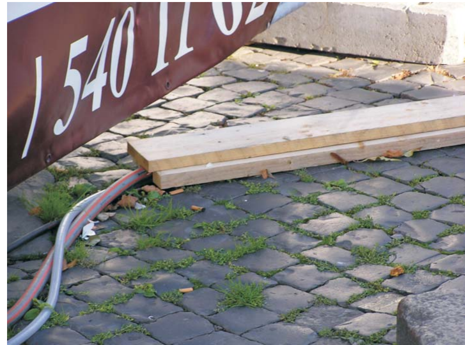
Bild 6: Kabelabdeckung mit Holzlatten (ungünstig)
